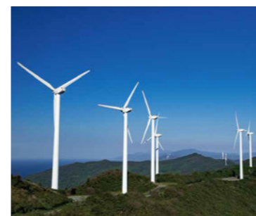
風力発電設備
