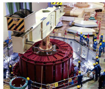
水力発電設備
