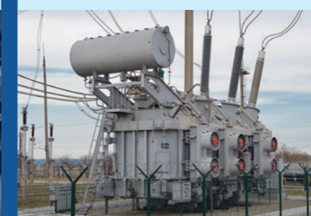
変電所に設置されている変圧器の 冷却ファン設備の異音を監視
