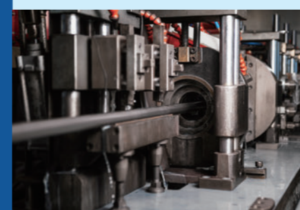
工場に設置されている 圧延設備の異音を監視
