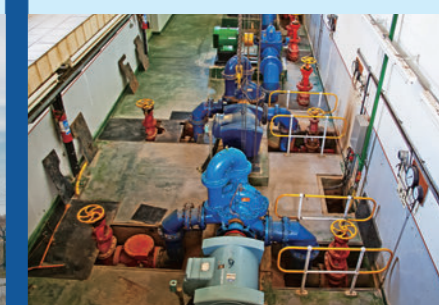
配水場に設置されている ポンプ設備等の異音を監視
