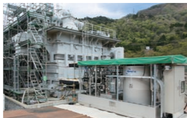
超大型変圧器と溶剤洗浄装置(右)
