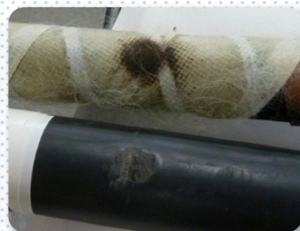
外傷からの内部焼損
