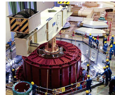
水力発電設備
