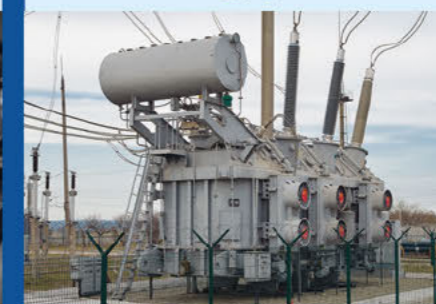
変電所に設置されている変圧器の冷却ファン設備の異音を監視
