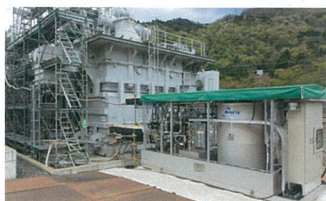
超大型変圧器と 溶剤洗浄装置(右)
